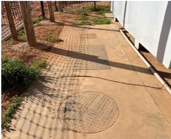
Foto 292 – Caixa SAO do tanque de combustível (Data: 27/06/2022)
