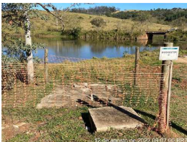
Foto 304 – Biodigestores do canteiro administrativo. (Data: 12/08/2022)
