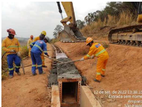
Foto 281 – Canaletas de drenagem definitiva. (Data:12/09/2022)
