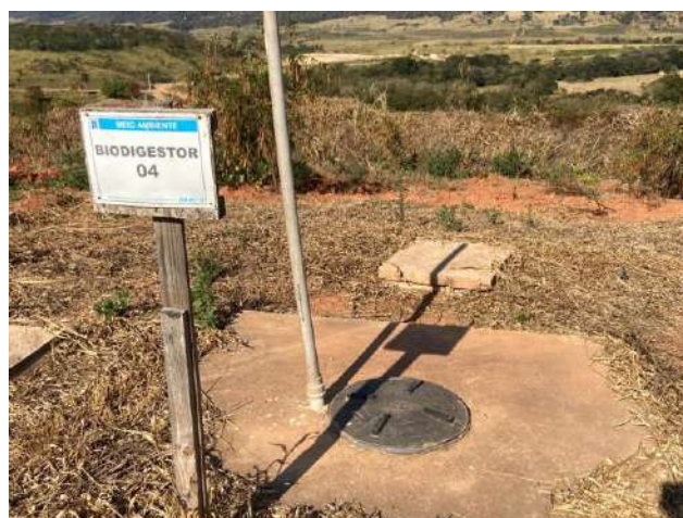
Foto 305 – Biodigestores do canteiro industrial. (Data: 19/08/2022)
