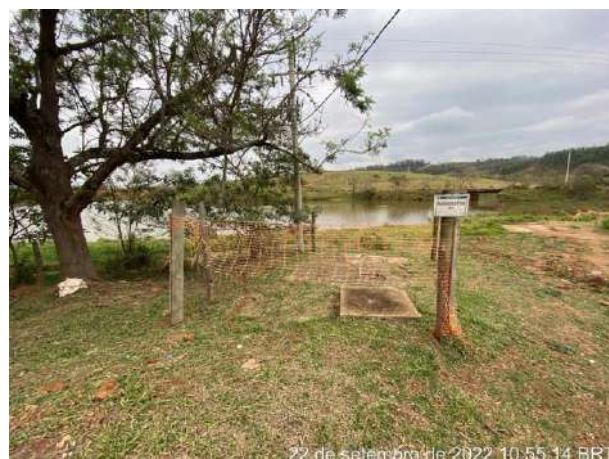
Foto 307 – Biodigestores do canteiro administrativo. (Data: 22/09/2022)
