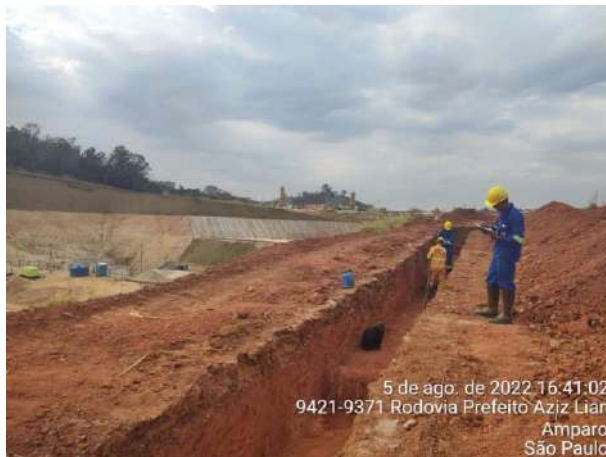
Foto 279 – Canaletas de drenagem definitiva. (Data:05/08/2022)
