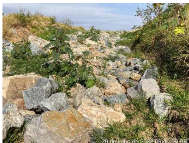
Foto 232 – Enrocamento com disciplinamento do fluxo para as caixas de retenção Bota Fora 01. (Data: 29/07/2022)
