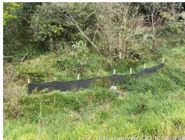
Foto 267 – Barreira de retenção de sedimento. (Data: 26/08/2022)
