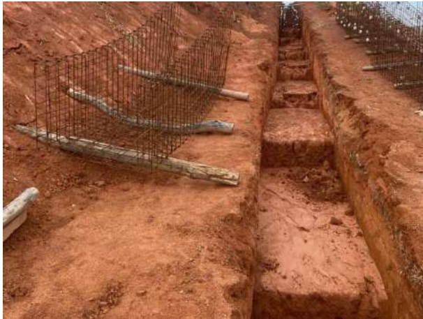
Foto 277 – Canaletas de drenagem definitiva (Data:21/07/2022)
