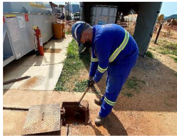
Foto 293 – Limpeza da caixa de inspeção e canaletas da área de manutenção. (Data: 27/06/2022)
