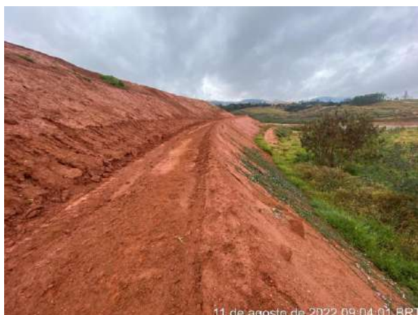
Foto 204 – Leira de proteção no entorno do bota espera com inclinação para a saída do talude. (Data: 11/08/2022)
