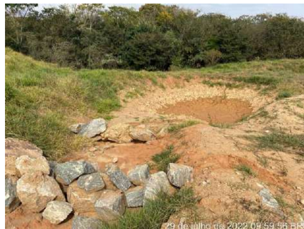
Foto 261 – Cacimba de retenção de sedimento. (Data: 29/07/2022)
