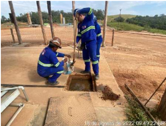
Foto 296 – Limpeza da caixa de inspeção e canaletas da área de manutenção. (Data: 18/08/2022)
