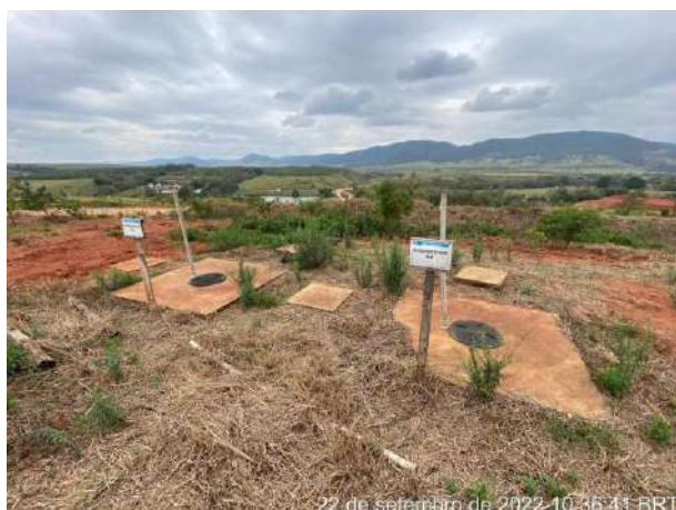
Foto 306 – Biodigestores do canteiro industrial. (Data: 22/09/2022)
