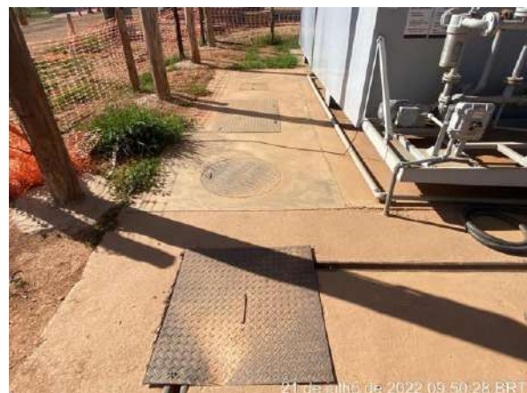
Foto 295 – Caixa SAO do tanque de combustível. (Data: 21/07/2022)
