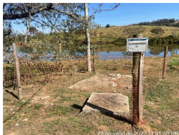
Foto 303 – Biodigestores do canteiro administrativo. (Data: 22/07/2022)
