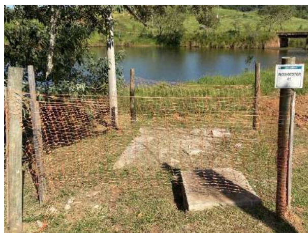
Foto 301 – Biodigestores do canteiro administrativo. (Data: 11/06/2022)
