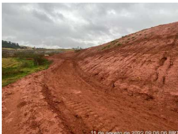
Foto 206 – Vista para leira e inclinação e direcionamento para saída do talude. (Data:11/08/2022)
